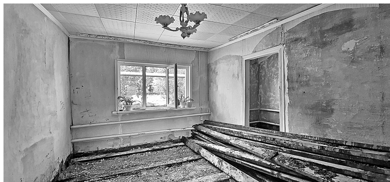
Полы после подтопления пришлось снять
